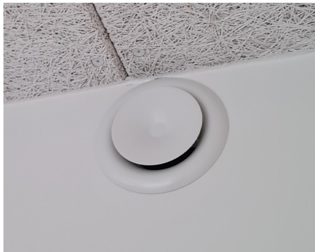
Indblæsningsventil i beboelsesrum
